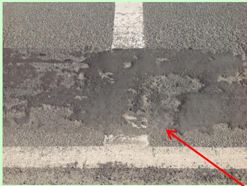
薄層補修破損例
