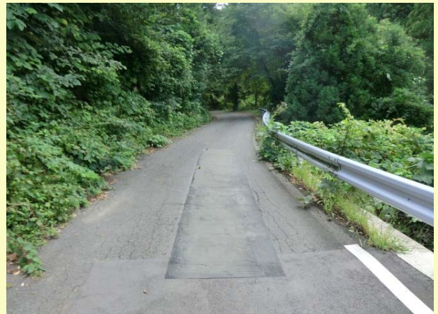
段差修正（秋田県八郎潟町） 交通条件：N3交通以下 施工半月後 良好
