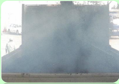
通常の改質アスファルト 180°Cでのアスファルト混合物出荷状況
