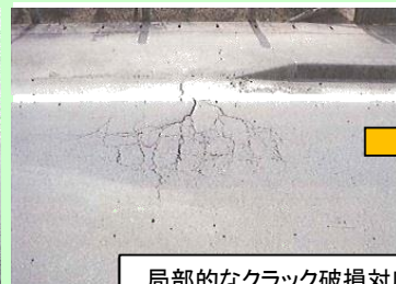
局所的なクラック破損対応
