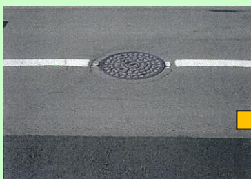
マンホール周りの微量な段差
